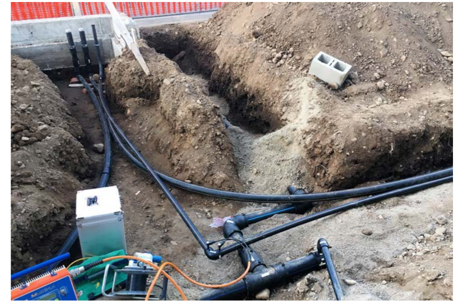
Immagine 26 Fotografia rete distribuzione gas Particolare partenza linee gas metano
