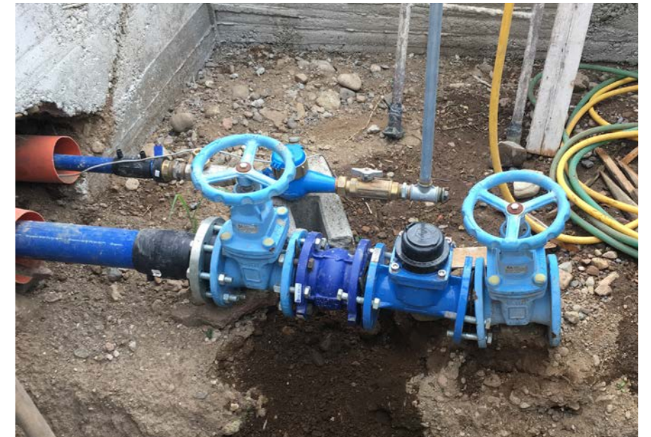
Immagine 24 Fotografia vano contatori Particolare allaccio rete idrica ed antincendio
