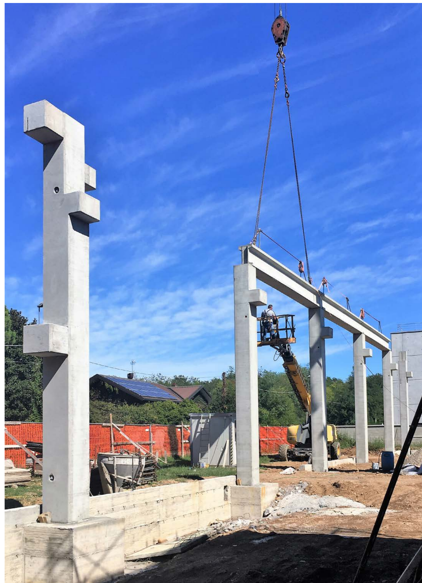
Immagine 13 Fotografia montaggio struttura prefabbricata Particolare posa travi piane in c.a.p. a doppio T
